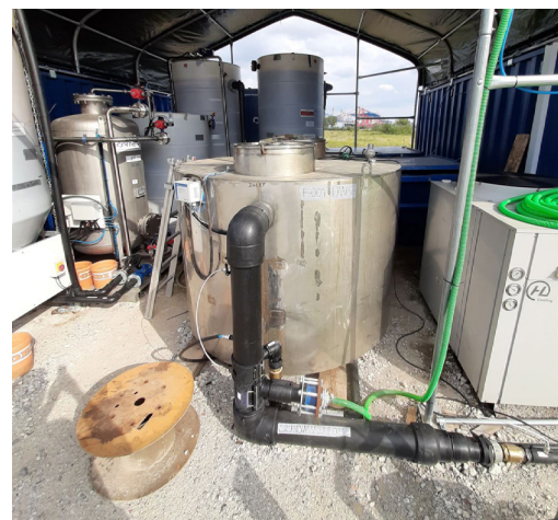
Ausschnitt aus der Grundwasserreinigungsanlage
