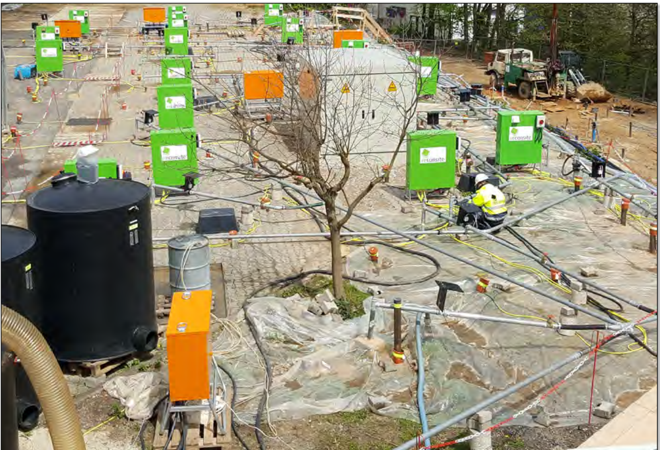
Abb. 8a: Blick auf eine thermische in-situ Sanierung mit dem THERIS®-Verfahren (feste Wärmequellen)
